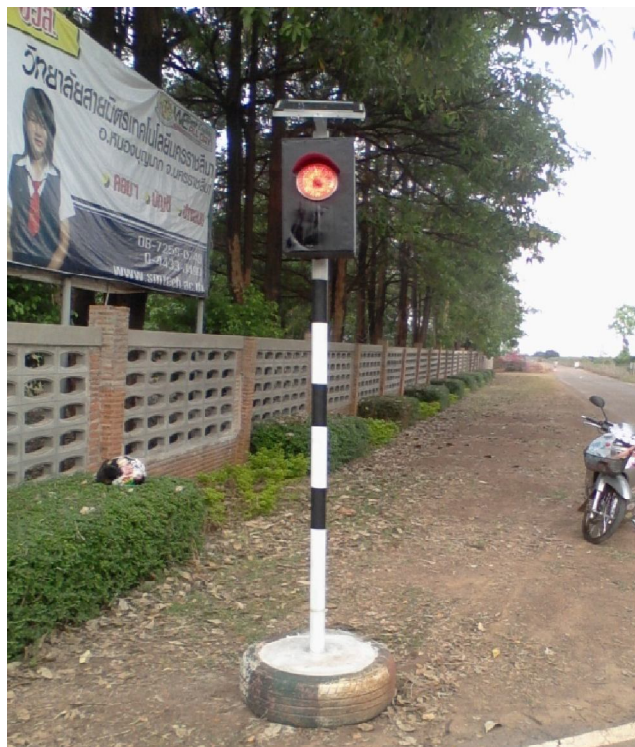
รูปที่ 3.2.10 ไฟสัญญาณจราจรพลังงานแสงอาทิตย์
